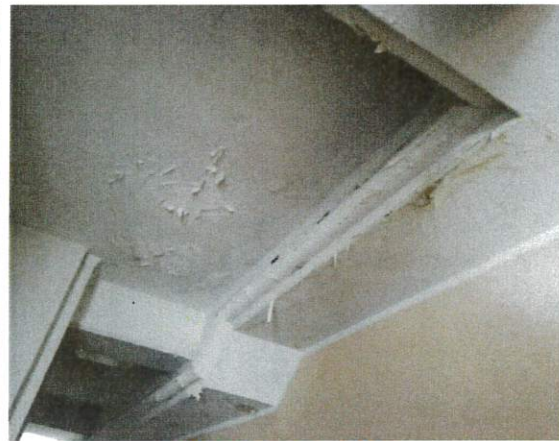
Infiltrazioni di umidità
