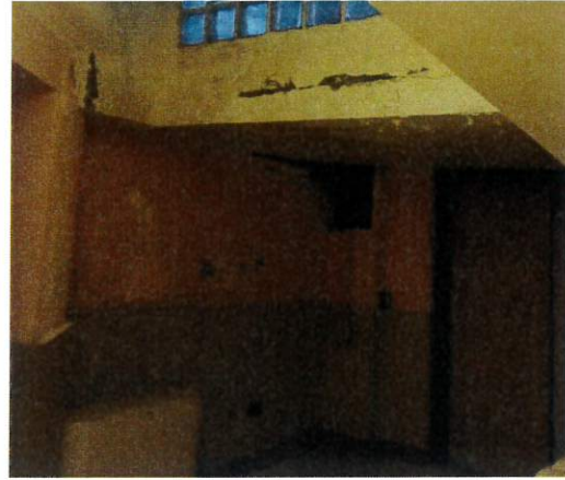
Infiltrazioni di umidità
