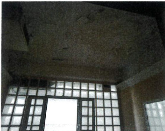
Infiltrazione di umidità
