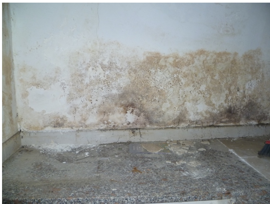
Foto n. 16 – Umidità di risalita PS
