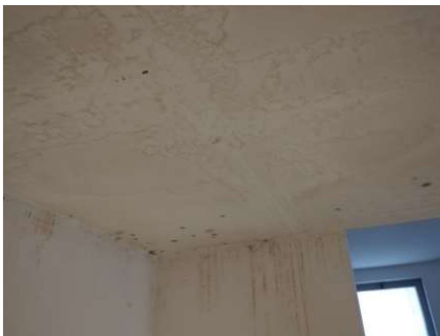
PARTICOLARE INFILTRAZIONI NEL CONTROSOFFITTO ZONA INGRESSO
