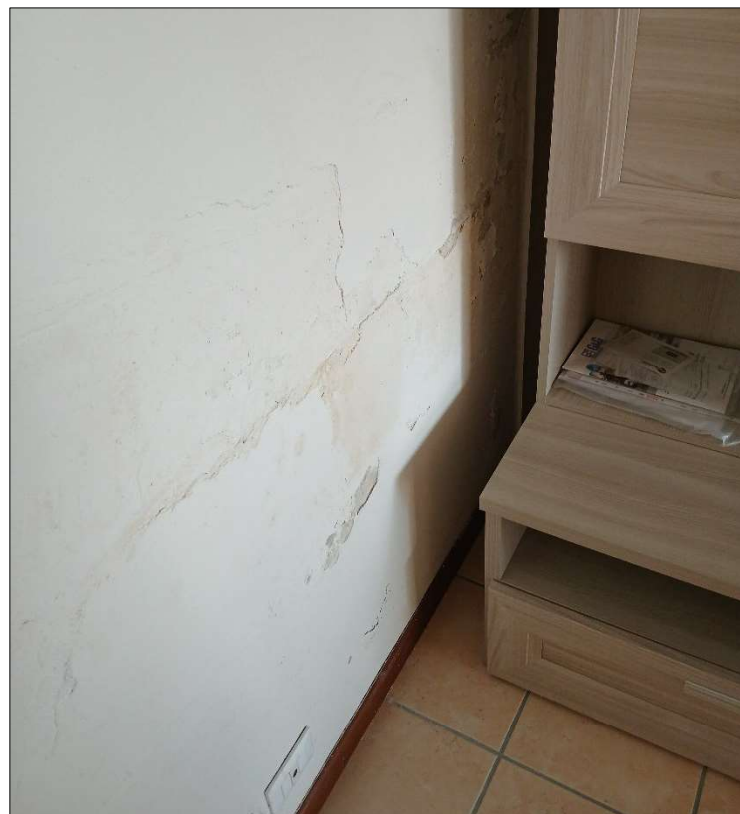
Foto n. 35 – Particolare p.1° (sub.2) Abitazione – Particolare muratura umida nel soggiorno
