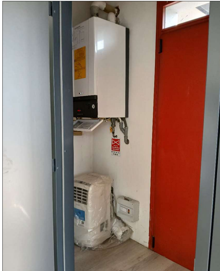
Foto n. 15 – Particolare p.t. (sub.1) centrale termica
