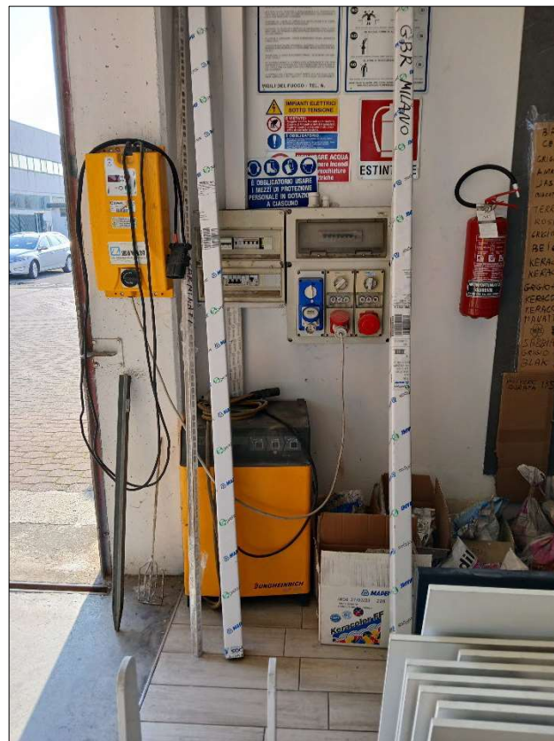
Foto n. 19 – Particolare p.t. (sub.1) magazzino/deposito – Quadri e comandi impianti
