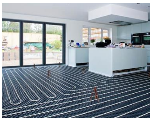
Sistema riscaldamento radiante a pavimento
