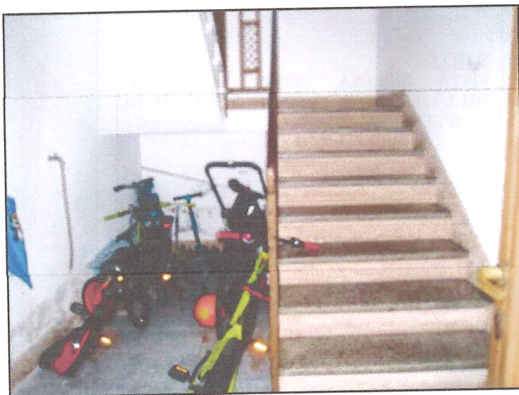
FOTO 5 VISTA RIPRESA ALL'INTERNO DELL'INGRESSO VANO SCALE COMUNE DEL FABBRICATO CHE COMPENDIA L'UNITA' IMMOBILIARE DI ABITAZIONE OGGETTO DI PROCEDURA ESECUTIVA.
