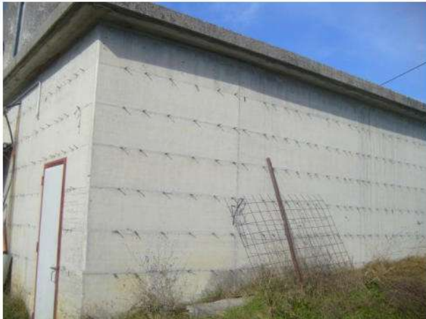
Vasca di accumulo acqua
