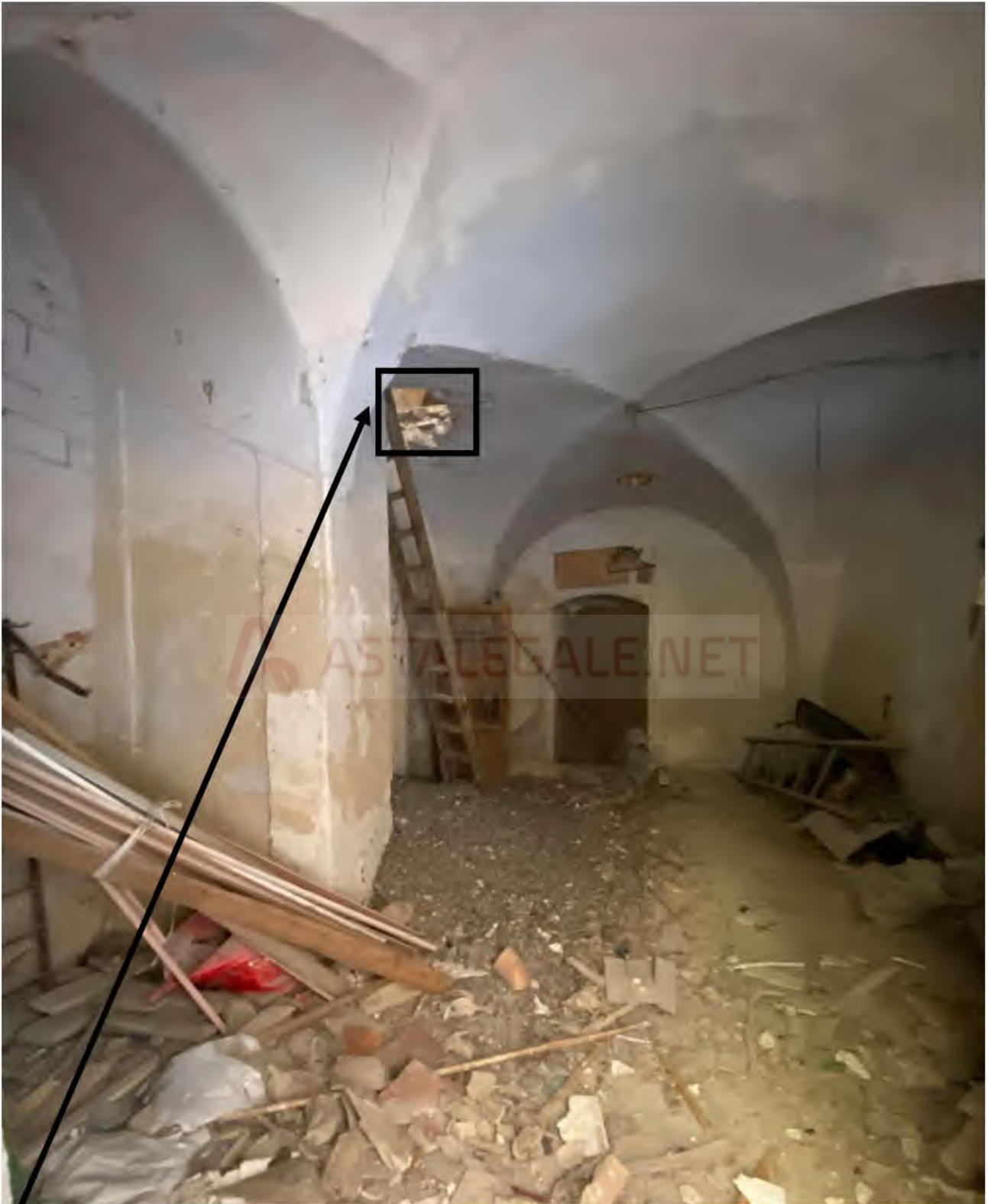
Porzione di solaio crollato, da cui si accede al Piano Primo (tramite scala in legno)
