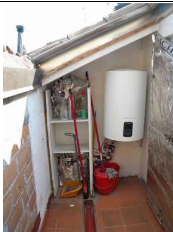
Dettaglio boiler nel L.T. (Locale tecnico) parzialmente scoperto – 2°P
