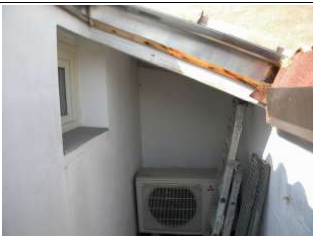
Dettaglio unità esterna pompa di calore marca Mitsubishi nel L.T. (Locale tecnico) parzialmente scoperto – 2°P
