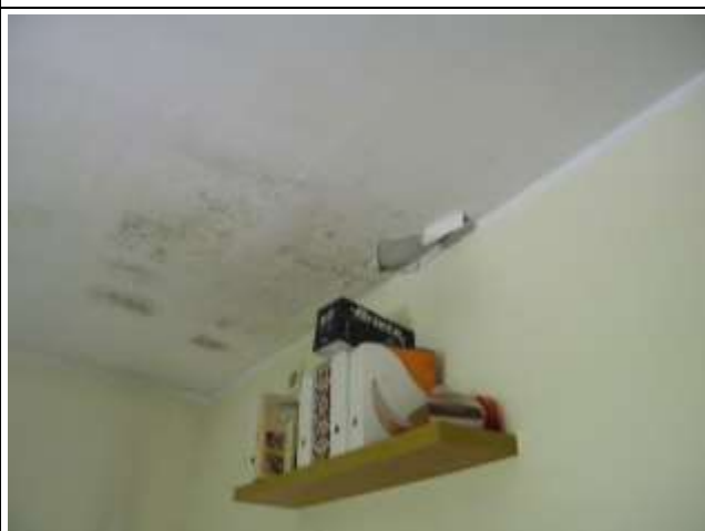
Dettaglio infiltrazioni - 2°P
