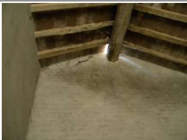
Dettaglio tegole rotte in soffitta - 3°P
