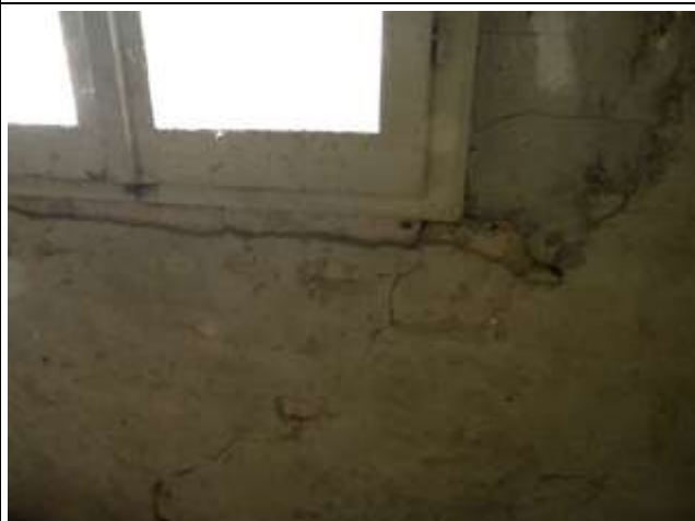
Dettaglio crepe in soffitta - 3°P
