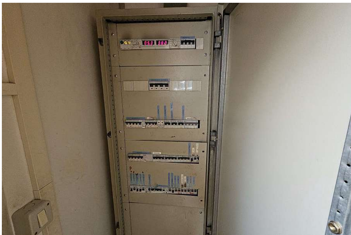
Quadro elettrico generale Lotto 002
