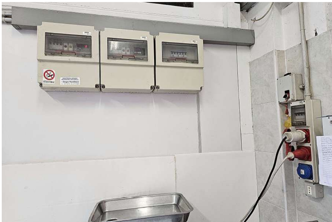
Ulteriori quadri elettrici nella zona di lavorazione
