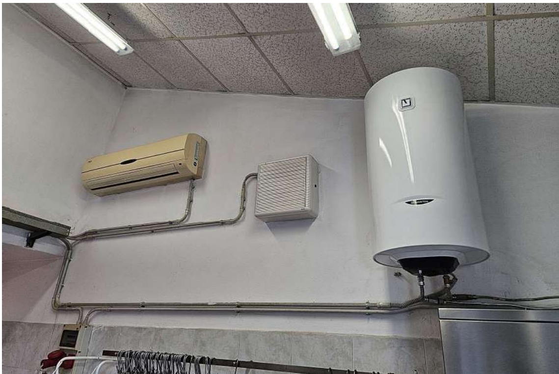
Particolare del boiler elettrico per la produzione di ACS
