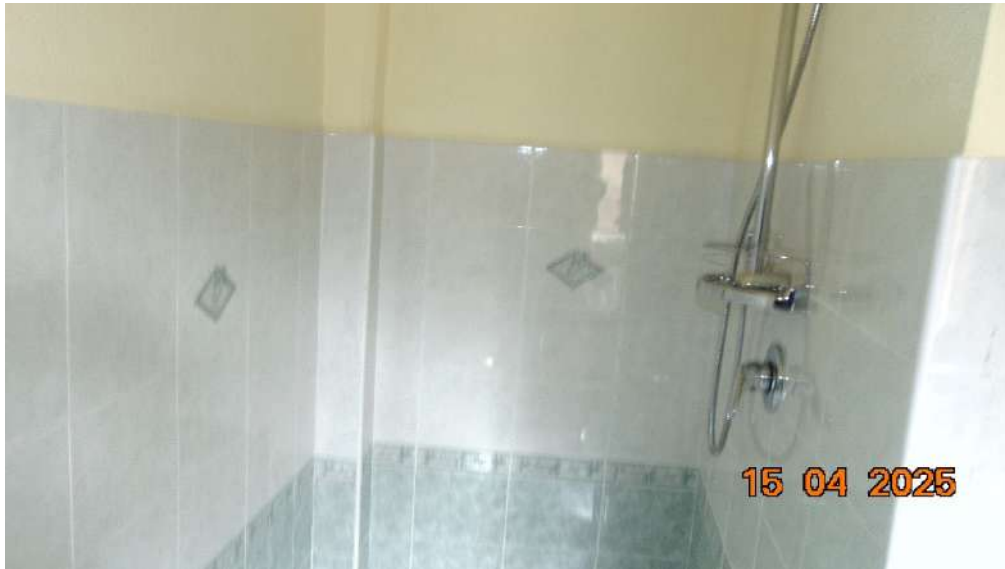
Bagno (Particolare doccia)
