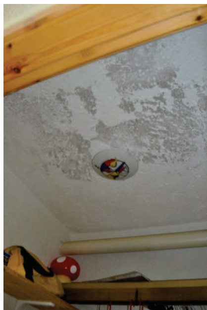
Figg.26-27. Dettaglio dell'umidità sul solaio
