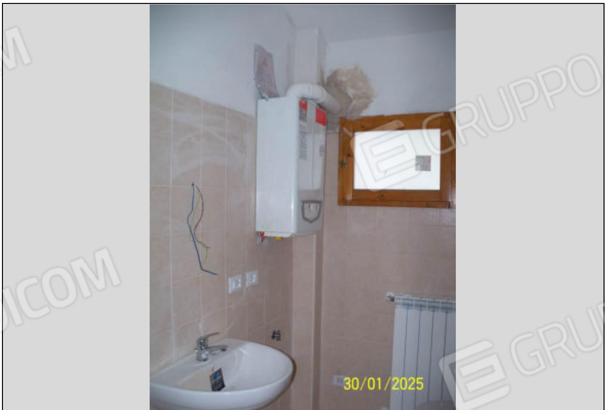
Vista interna: Caldaia murale posta nel bagno
