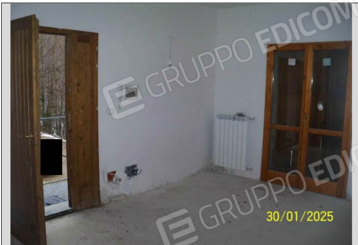
Vista Interna: Zona ingresso soggiorno dell'abitazione posta al piano terra di cui al sub.35 Si nota l'assenza completa della pavimentazione, delle porte interne e finiture
