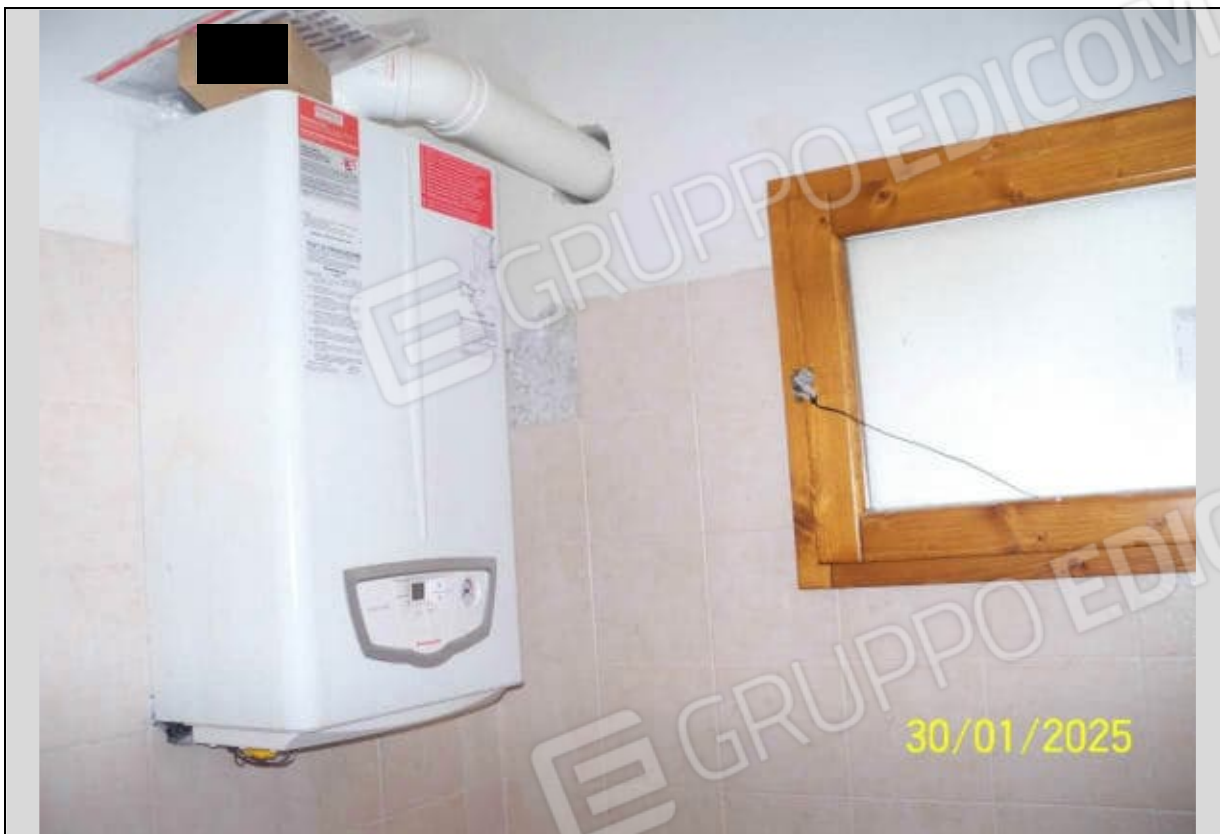
Vista Interna: Caldaia posta nel bagno
