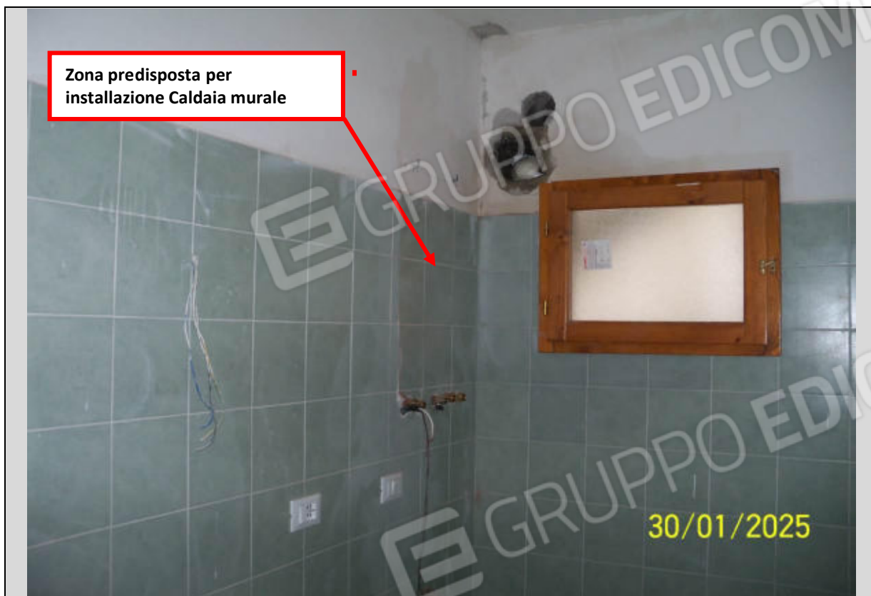
Vista Interna : bagno dell'abitazione posta al piano terra di cui al sub.33 Non risulta installata la caldaia (assente)
